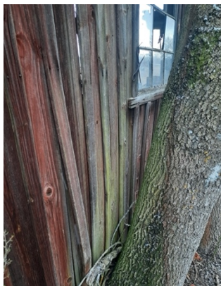
Figur 16 västra fasaden, bortfallna glasrutor samt träd för nära fasaden
