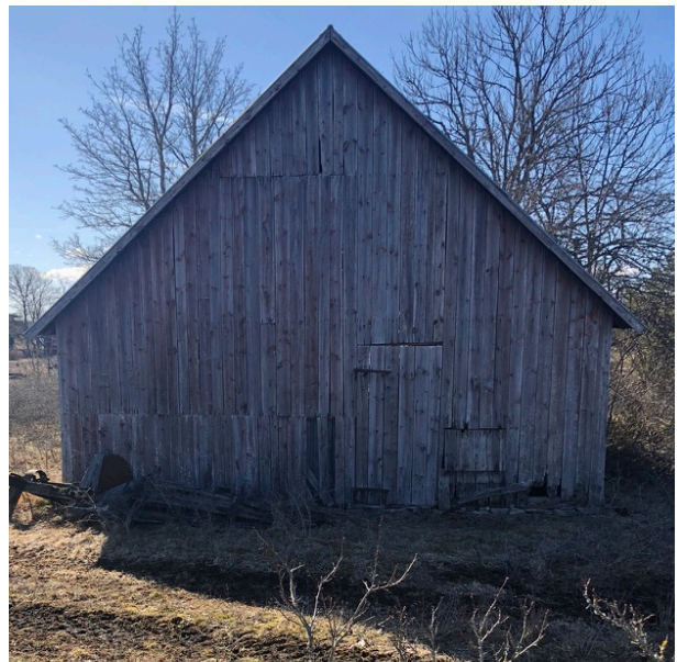
Figur 12 Skadade fasadbrädor och blottad syll på nordfasad.
