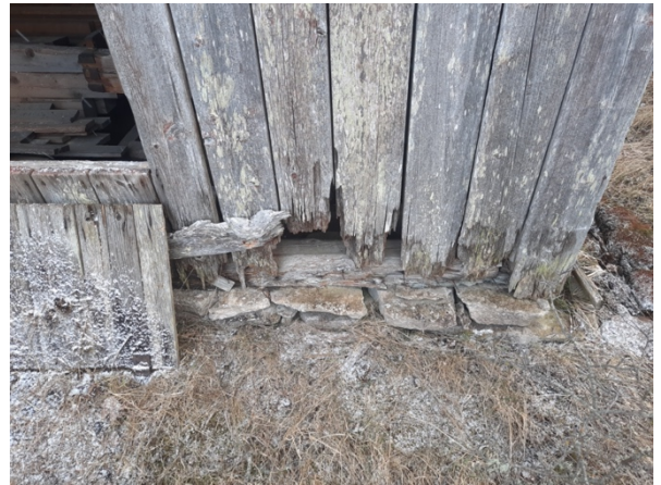
Figur 13 bortvittrad fasad panel på norra fasaden
